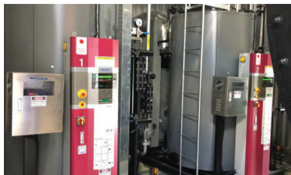
Caldeiras a gás marca Miura de 2 toneladas vapor/hora – Unidade Vinhedos.
