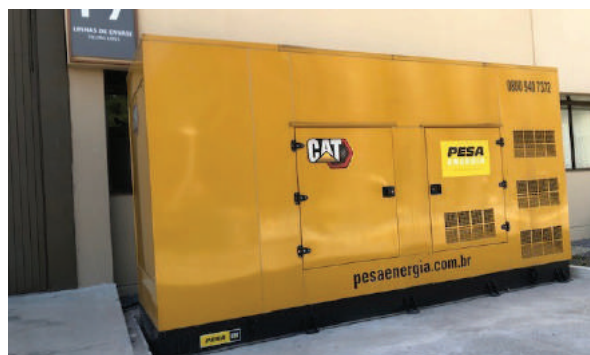
Gerador de Energia Unidade 3 (Vinhedos).
